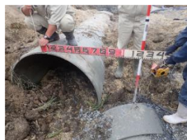
図1 パイプの離脱
